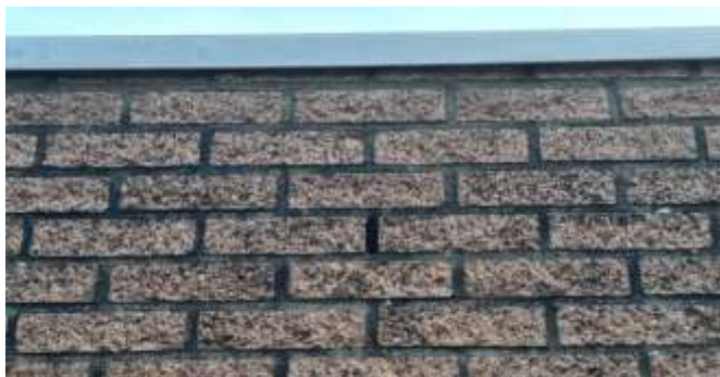
Figuur 13: Open stootvoeg in westelijk gedeelte bedrijfsgebouw
