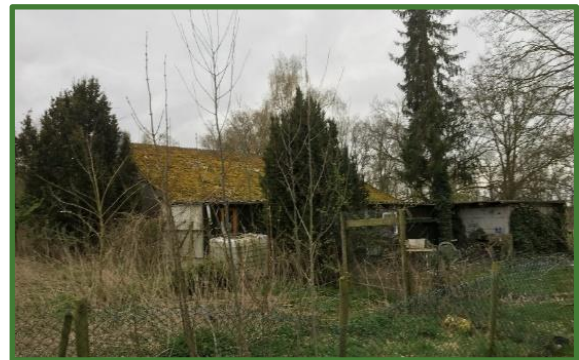
Figuur 6: Vervallen bebouwing (eigen foto)
