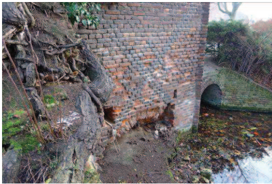
Slechte staat muurwerk (rechter hoek recent hersteld)
