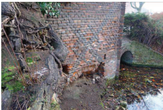
Slechte staat muurwerk (rechter hoek recent hersteld)
