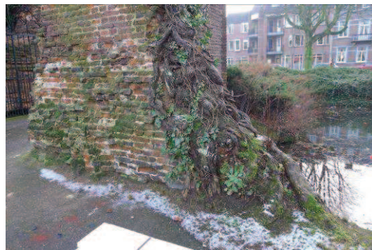
Sporen van afboerend muurwerk (op een plaats waar geen vrachtwagen langs komt)
