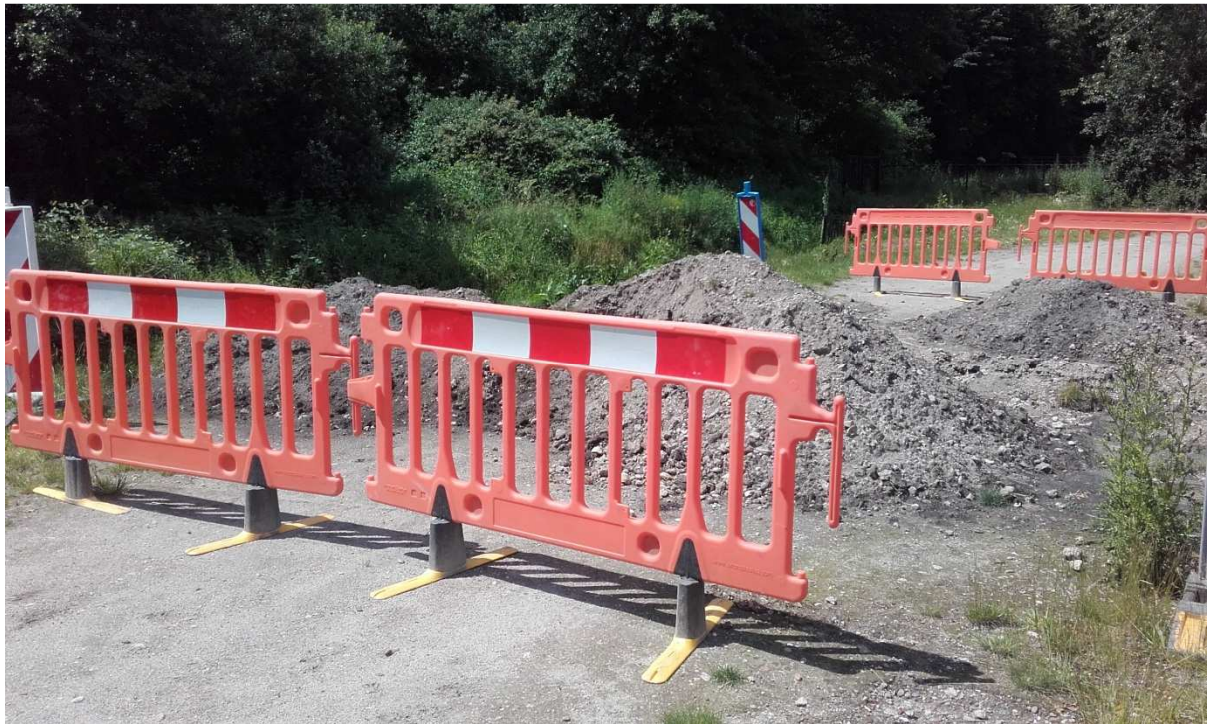
Afbeelding 1. De kering tussen het retentiebekken en de Leukerbeek doorgegraven. Ongezuiverd rioolwater stroomt de Leukerbeek in.
